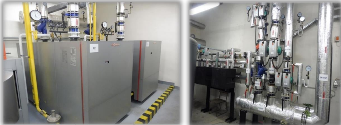
Pohľady do novorekonštruovanej kotolne nemocnice (2017)
